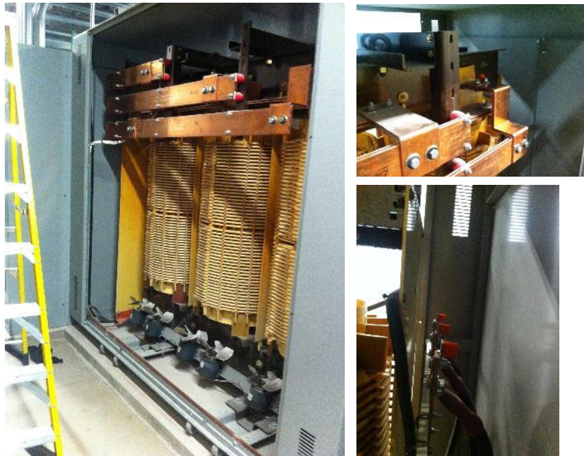
Transformadores de tipo seco
