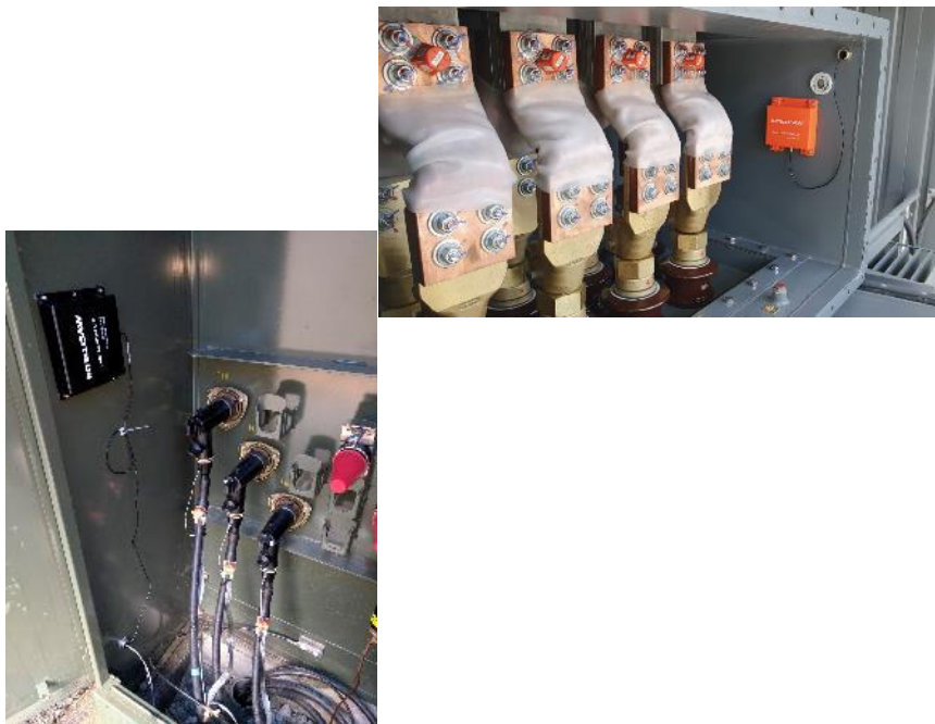
Transformador sumergido en aceite
