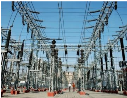
户外敞开式变电站
