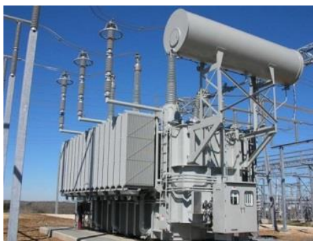
充油电力变压器
